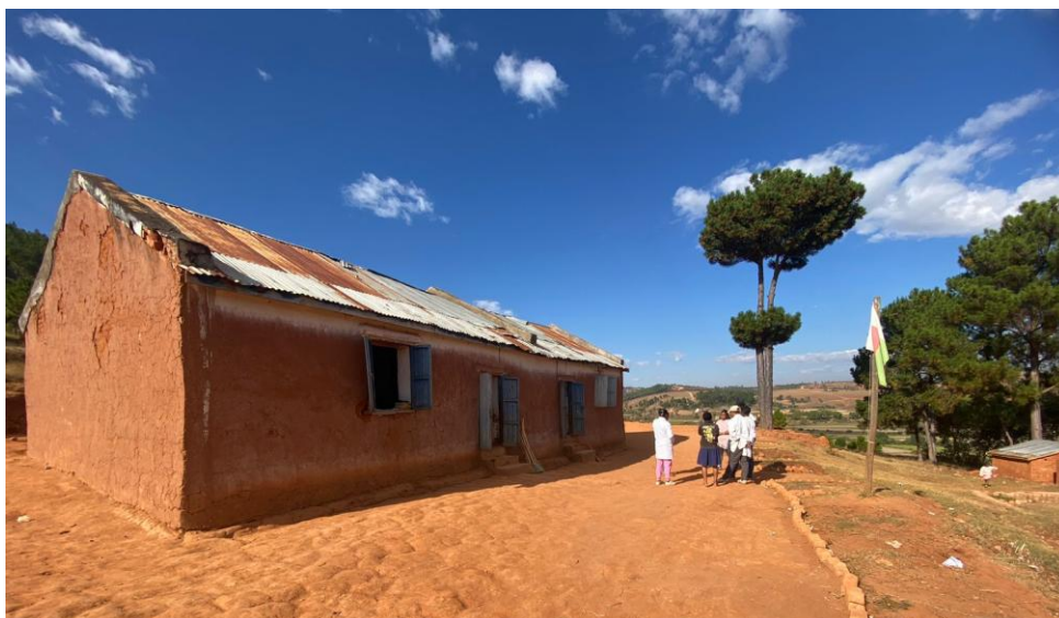
Figure 3 : Ancien bâtiment de classe de l'EPP Ambondrona, exposé à l'érosion et au vent cyclonique.
