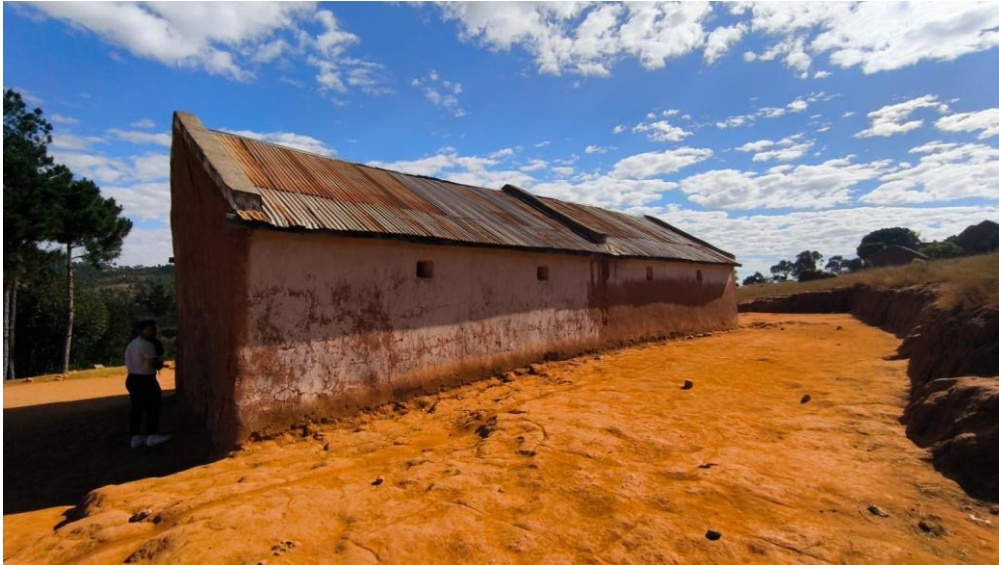
Figure 4 : Ancien bâtiment de classe de l'EPP Ambatofahavalo, exposé à l'érosion et au vent cyclonique (2).
